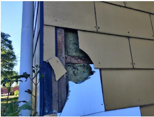
Abb. 10: Beschädigte Fassadenverkleidung als potenzieller Brutplatz für Vögel.
