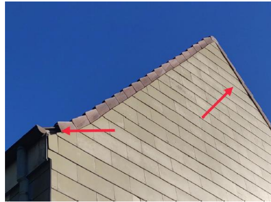
Abb. 11: Spaltenquartiere für Fledermäuse und Brutnische für Vögel am Grat.
