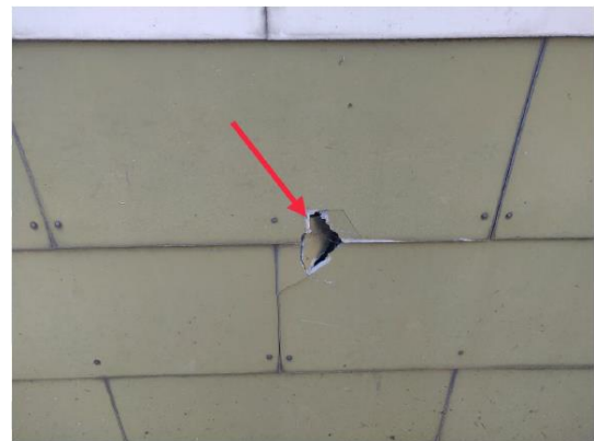
Abb. 13: Beschädigung der Fassade als potenzieller Einschupff für Vögel und Fledermäuse.
