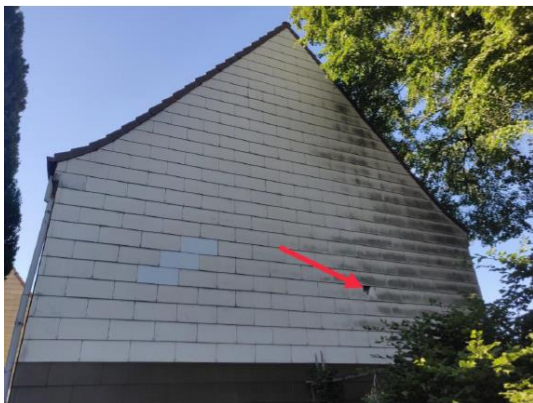
Abb. 12: Beschädigte Fassadenverkleidung als potenzieller Brutplatz für Vögel.
