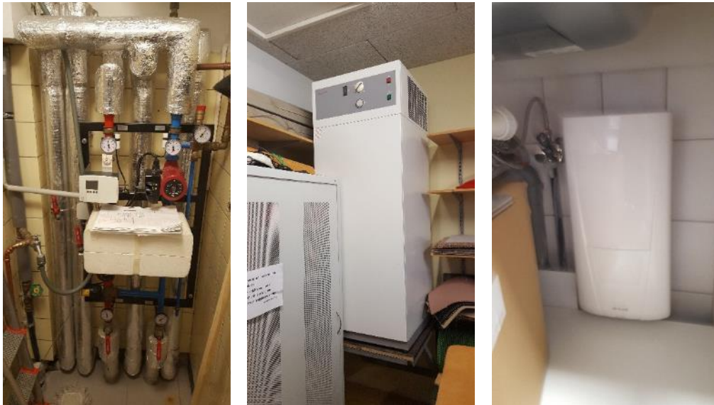
Abbildung 13: Aktuelle Heizungsanlage und Warmwasserbereitung
