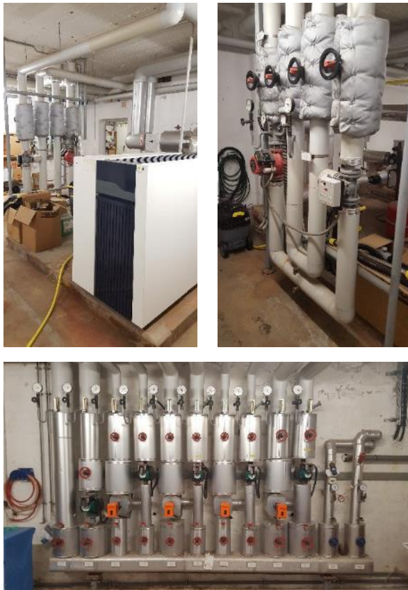
Abbildung 25: Aktuelle Heizungsanlage und Warmwasserbereitung
