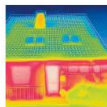
Vorab hatten die Planer bereits ein Einfamilienhaus in der Südstadt mit einer Thermografieaufnahme untersucht. Sie zeigt den Wärmeverlust an Gebäudeflächen. FOTO: ZEBAU
