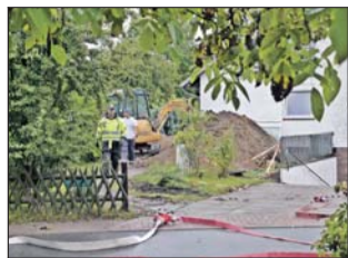
Bei Baggerarbeiten wurde gestern in einem Garten am Heideweg eine Gasleitung beschädigt. Foto hül
